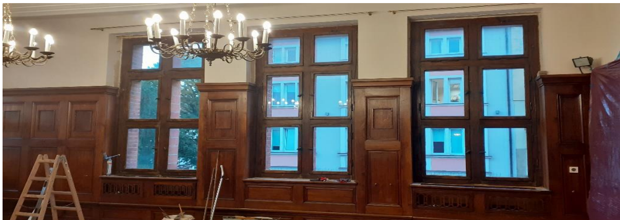
Okna Ratusza przed wymianą ( własne )
